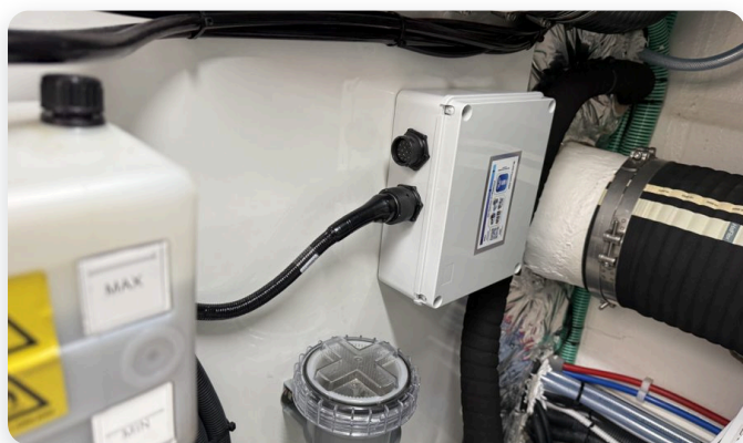
Controller montato con la spina HDP20 del Y-tap collegata e bloccata.
